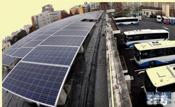
La sunenergiaj paneloj instalitaj sur la tegmento de la parkejo kaj aŭtobusoj ŝargataj per sunenergio
