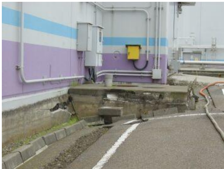
Detruita tereno en la nuklea centralo Kašiŭazaki-Kariŭa en Niigata kaŭzita de la tertremo en 2007. TEPCO riparas ĝin kaj provas refunkciigi tiun difektitan centralon.
