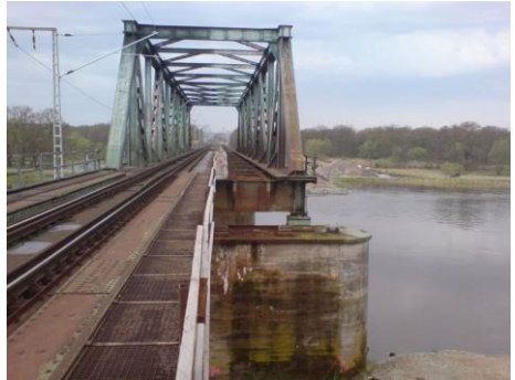
Nur ankoraŭ duone uzebla: la postmilita ponto en la jaro 2005 Nur noch halb zu gebrauchen: Die Nachkriegsbrücke im Jahr 2005 (Foto: Eisenbahnfreunde Frankfurt (Oder))
