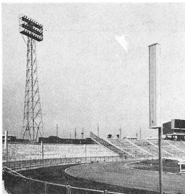
Stadio de Ibadan Projekcia lumigado kaj laŭtparola-instalaĵo Ibadan - Nigerio
