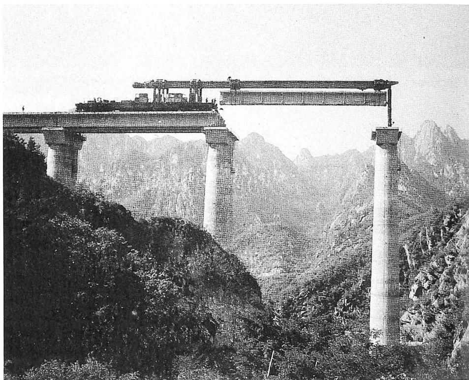
La du-traka elektrizita fervojo inter Datong kaj Qinhuangdao en konstruado. Ĝi iongas 653 km.
