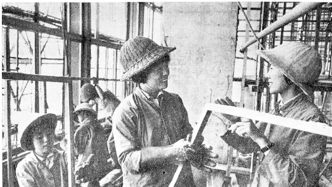
Ĝang Hiuking (meze), Vicsekretario de la partia komitato de la Ŝanhaja Konstrua Buroo, en konstruejo
