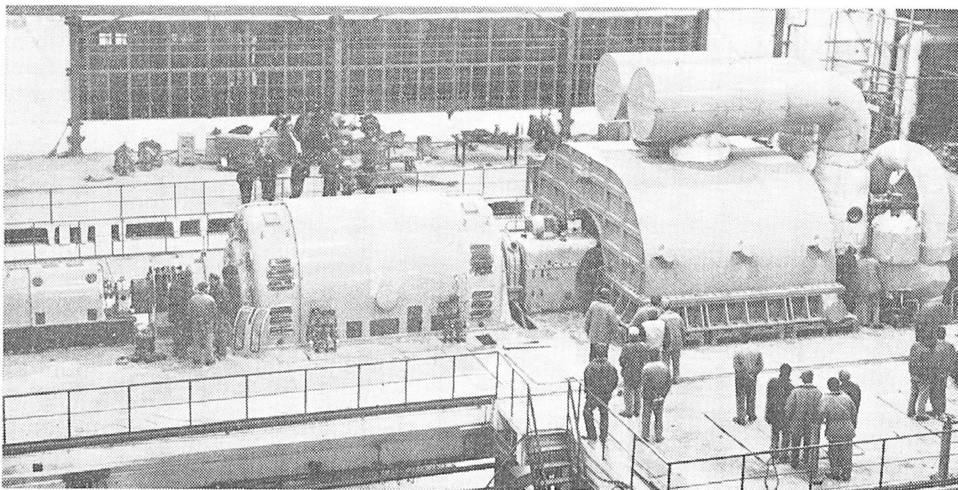
La generatora kompleto komencas prove funkcii.
